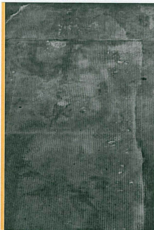
Kridtutfældning på fiberbetonplade
